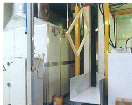
/ Beim Einlauf in die Roboterbeschichtung werden die Teile von einem 3D-Scanner exakt vermessen. Das funktioniert bis zu einer Bauteiltiefe von 45 cm.
